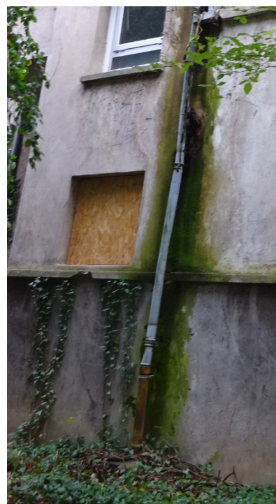
Fuite d'une descente d'EP
