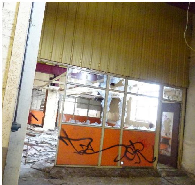
Espaces dégradés dans la halle de montage
