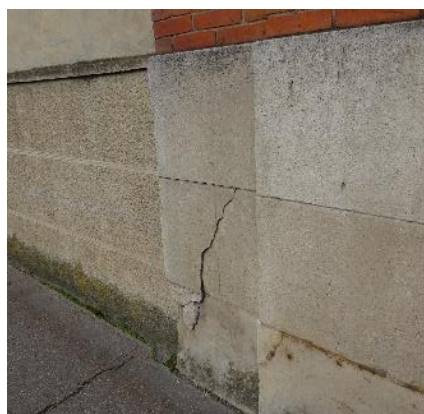
Fissure dans un élément maçonné du socle de la halle de montage
