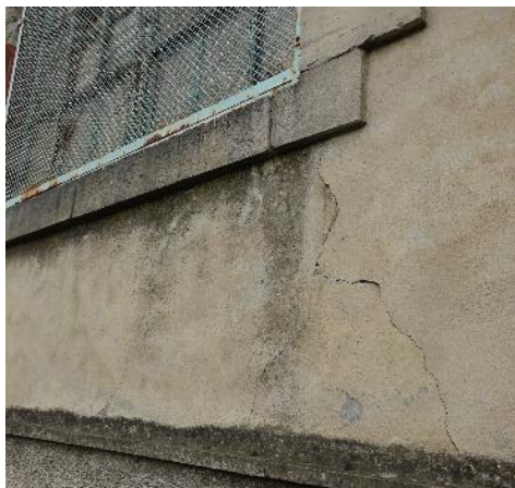
Fissures et salissures sous une baie
