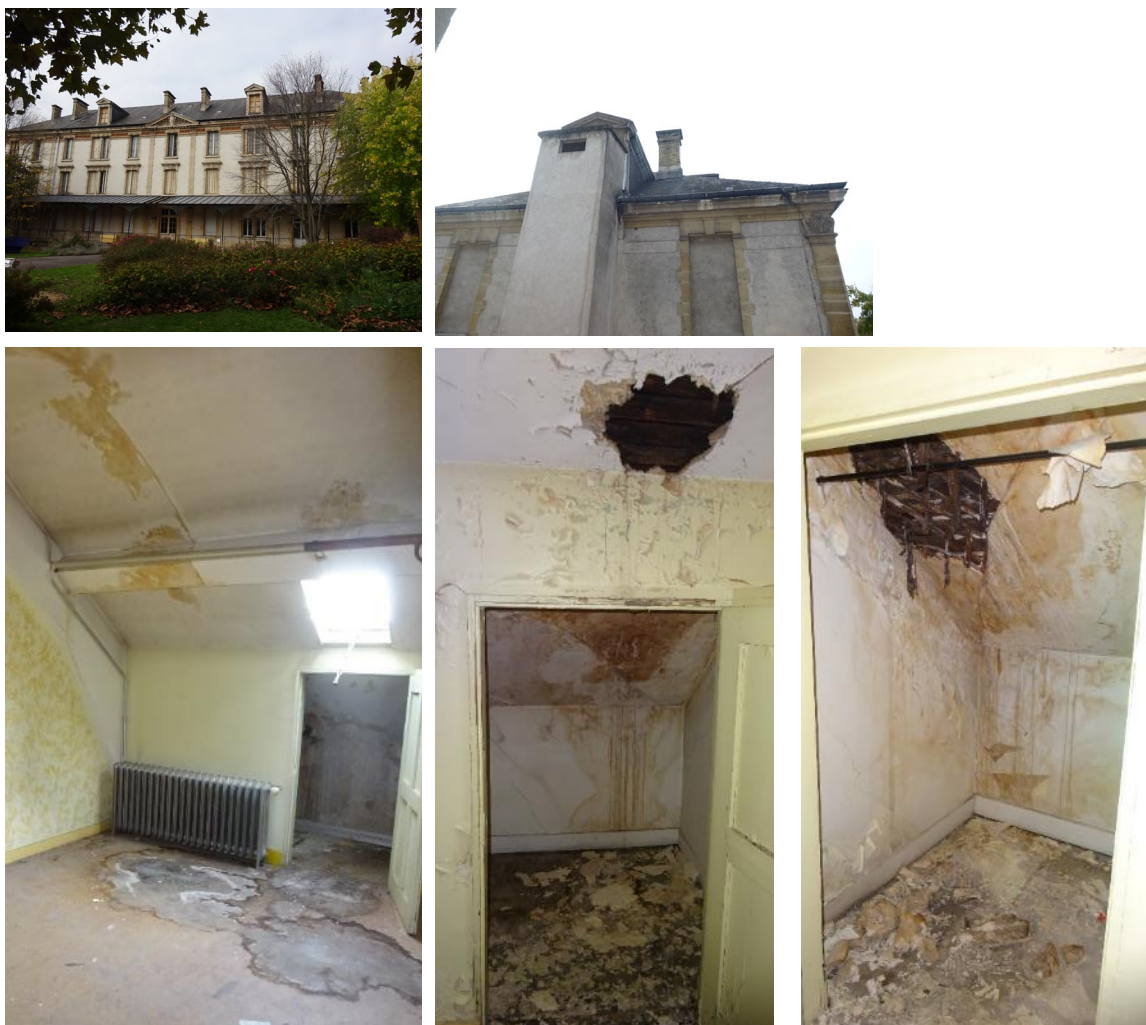
Nombreuses infiltrations dans la toiture du Pavillon Spillmann (J01)
