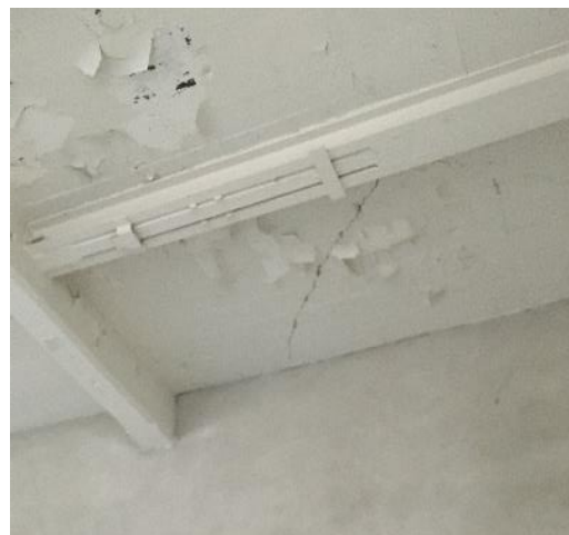
Fissure dans le plancher haut de l'ancienne chaufferie
