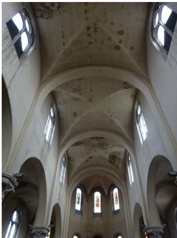
Nombreux points d'infiltration sur la voûte de la nef
