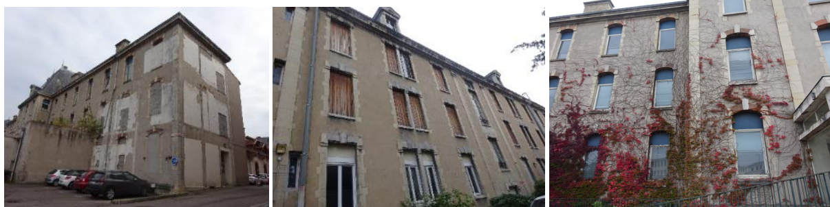
Façade porteuse maçonnée – état vieillissant et envahissement végétal
