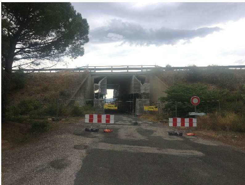
Voirie sous l'autoroute située au Sud-Ouest de la zone d'étude, favorable au franchissement de l'A9 par les Chiroptères et gîte potentiel (présence de fissures) R. DAWÉ, 02/07/2020, Rivesaltes (66)
