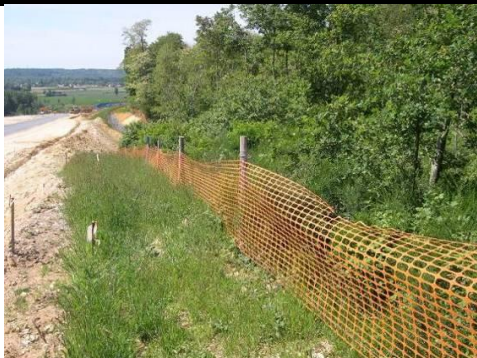
Exemple de barrière de chantier (Source : Egis)
